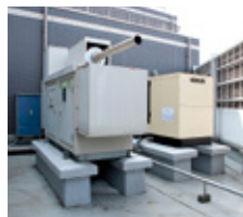
ガス(写真右)と軽油による発電装置 津波などの災害で電気が止まることを想定し、発電機を2階屋上に備えています。
